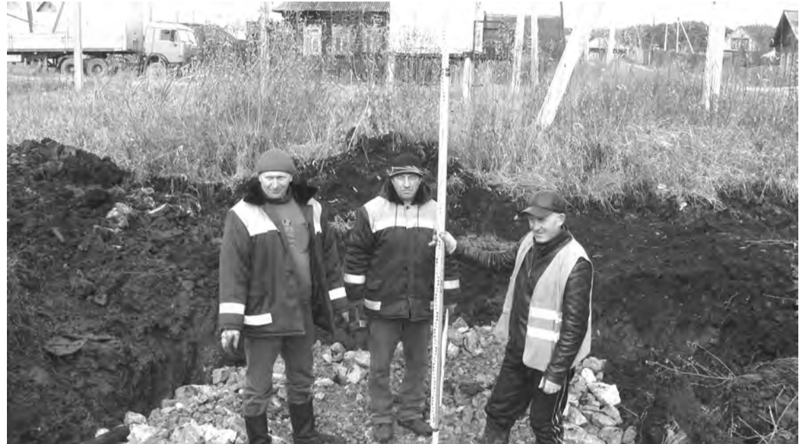
Наконец-то ул. К. Маркса в п. Троицком дождалась ремонта. Дренажный скальный грунт укладывает бригада Н.Колотыгина
