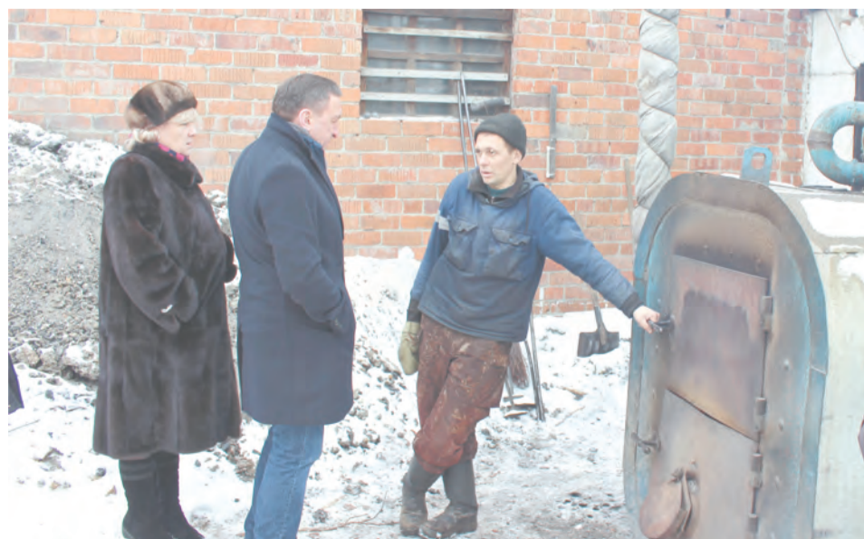
Угля в котельной нет. Котел работает на дровах
